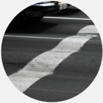
DEFORMACJE I ZNISZCZENIA POWIERZCHNIOWE
